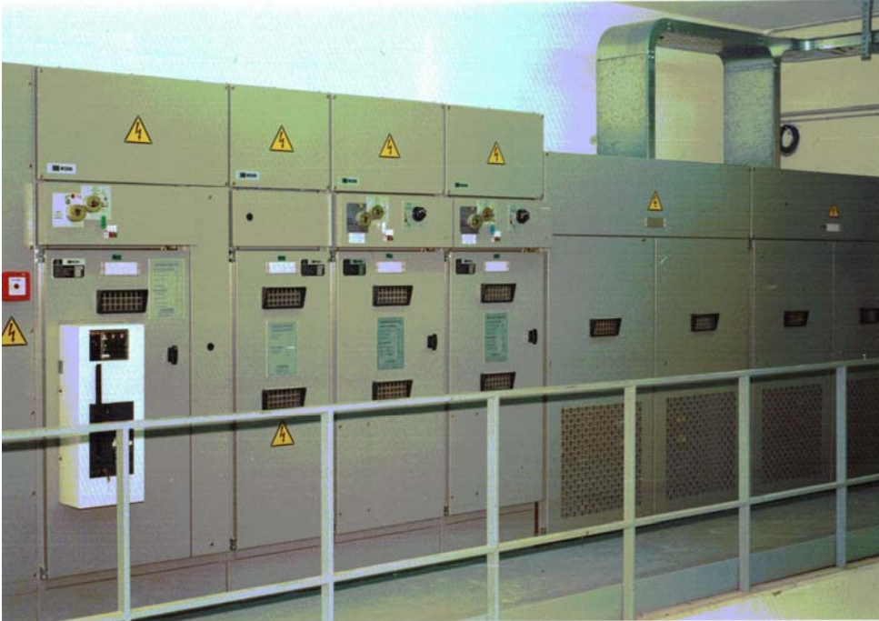
(Fig.6 – Vista frontale del quadro di M.T. isolato in aria e dei box trasformatori MT/BT)
